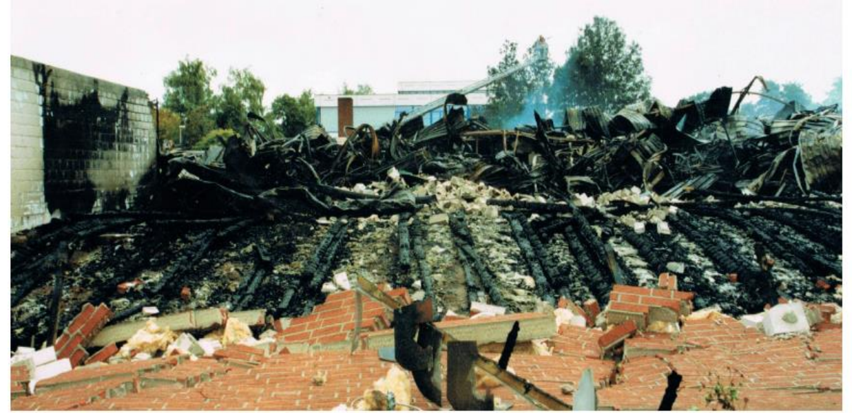
Die Sporthalle ist bis auf die Bodenplatte und Fundamente vernichtet worden.
